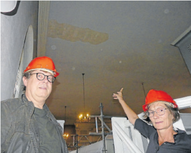
Pastor Jan-Peter Schulze und Kirchenvorstand Meike Schröder hoffen, dass Geld für die Sanierung der Krautsander Kirchendecke zusammenkommt. Am oberen Bildrand ist der Deckenschaden zu sehen. Foto: Knappe
