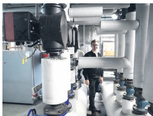
Center- & Operations-Manager Lars Wiesener in der Heizungszentrale des Sirius Business Parks Buxtehude: Von hier aus werden alle Hallen und Büros zentral mit Wärme versorgt.
