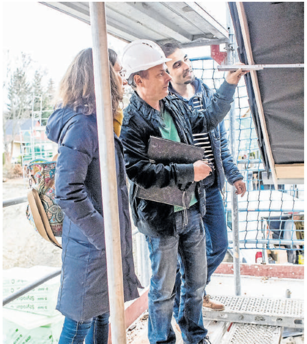
Da Mängel im Neubau keine Ausnahme sind, ist eine unabhängige baubegleitende Qualitätskontrolle eine sinnvolle Investition für Bauherren.
